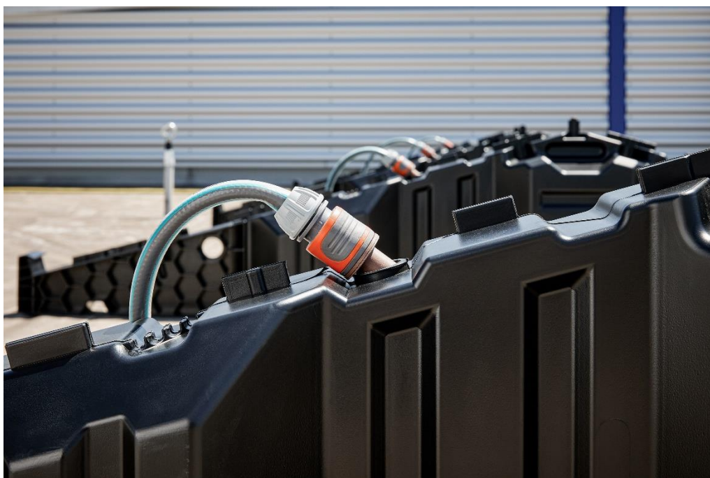
Naplněním nádrží vodou až po odpovídající přepadový otvor je systém individuálně zatížen. Foto: Zambelli Holding GmbH
