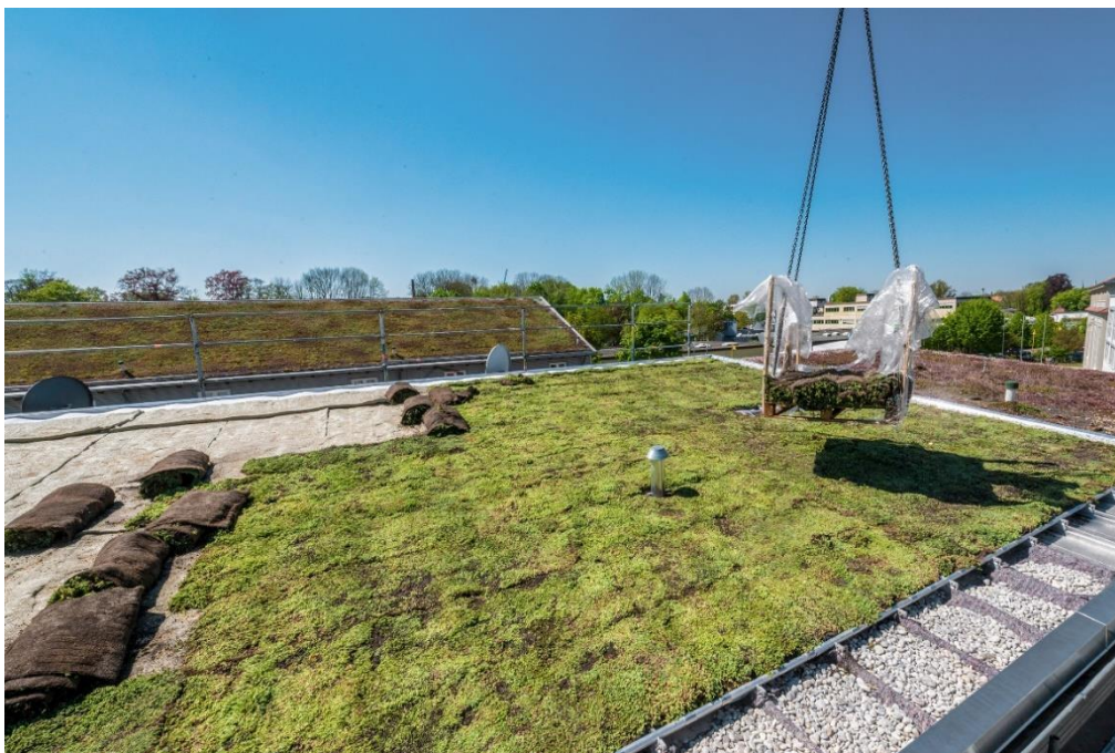
Das Gründach-Komplettsystem von Zambelli RIB-ROOF und KNAUFINSULATION punktet in Sachen Nachhaltigkeit. Es eignet sich aufgrund seines geringen Gewichtes besonders für flachgeneigte Dächer. Foto: Zambelli Holding GmbH
